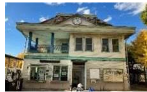
管理事務所（1984年整備）は雨漏り等の老朽化が目立つ
