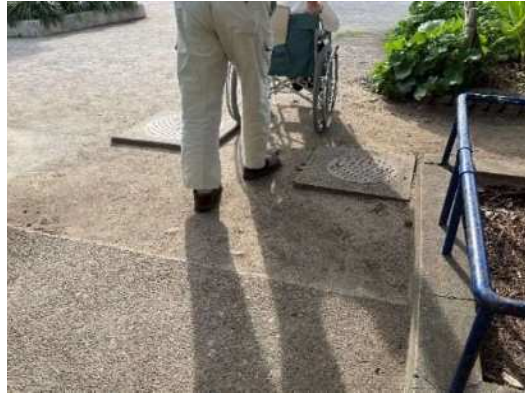
公園内の園路の段差
